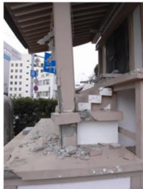
義公祠堂本殿崩壊
