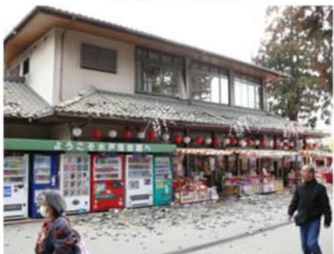
偕楽園レストハウス屋根瓦崩落
