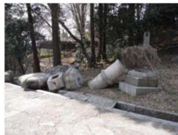
正面石段脇大石灯笼倒壊
