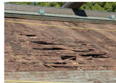
拝殿銅葺屋根下地老朽
